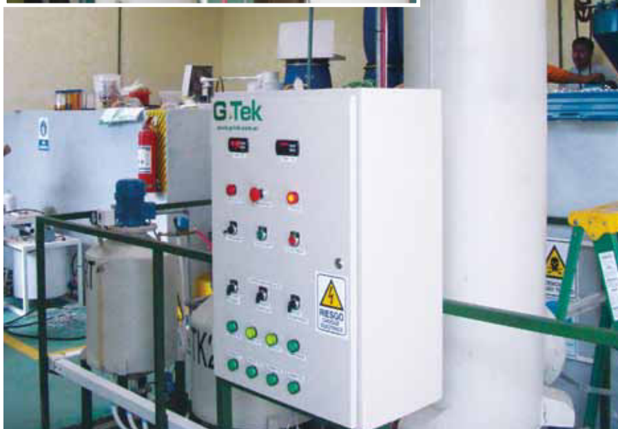
Planta piloto en funcionamiento (biodiesel).
